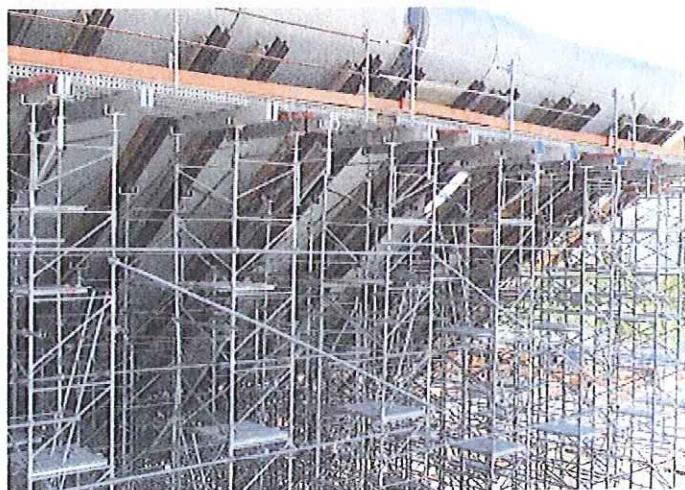
Les tours d'étalement supportant les éléments préfabriqués inclinés reposent sur des dalles et pieux de fondation provisoires.
