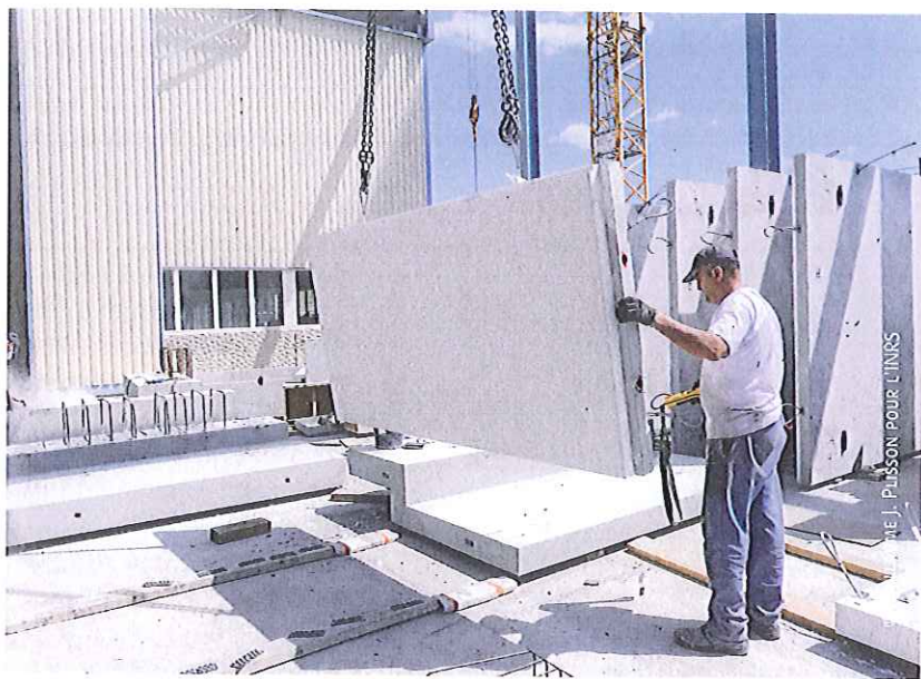
À l'extérieur des bâtiments, les produits sont acheminés à l'aide de ponts roulants, puis stockés sur des râteliers.
